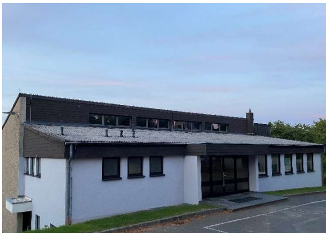
Abbildung 63: Asbestbelastetes Dach der Gemeindehalle aus dem Jahr 1983 (Quelle: Horst Gorges)
